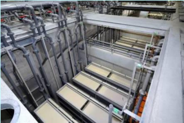
守山水処理センターの膜ろ過設備
