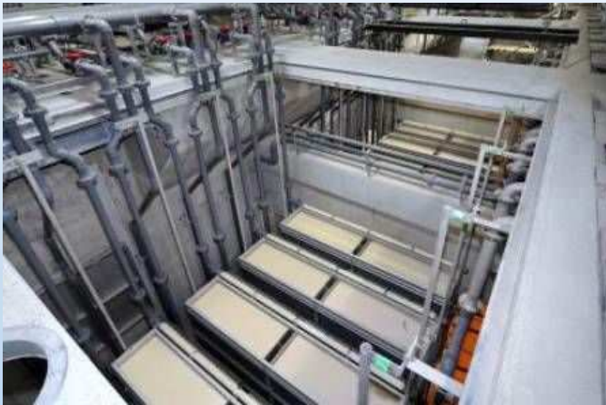
守山水処理センターの膜ろ過設備
