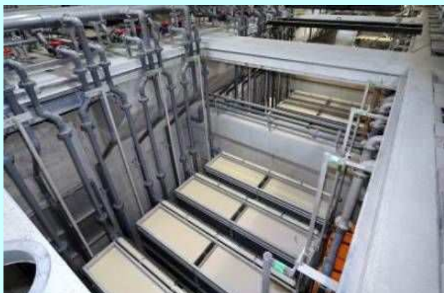
守山水処理センターの膜ろ過設備
