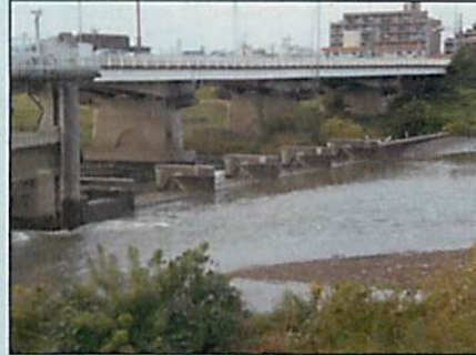
(右岸側) 転倒ゲート×4基
